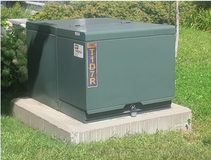
Transfo et PA (BR boîte de raccordement)
